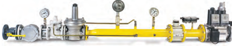
Doğal Gaz Kontrol Hattı
